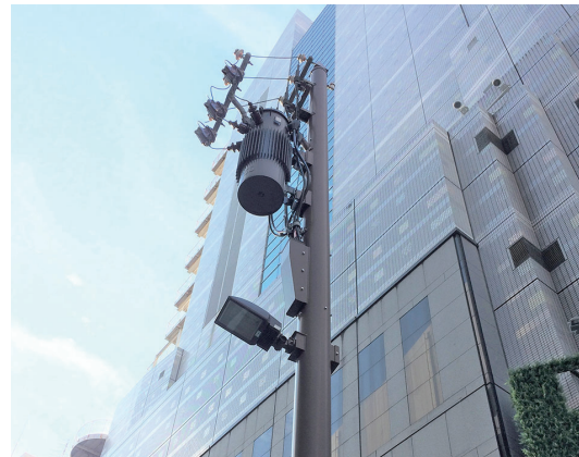
変圧器共用型街路灯柱(鋼管柱)
