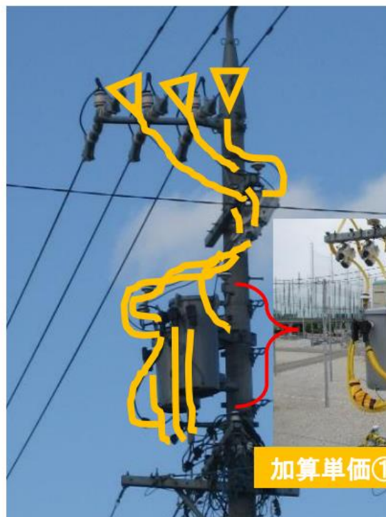
施工後 (取付範囲: 変圧器のみ)
